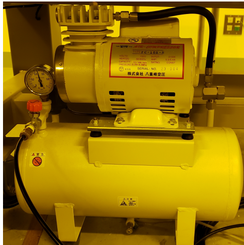
図 16: 防振台用の空気ポンプ
