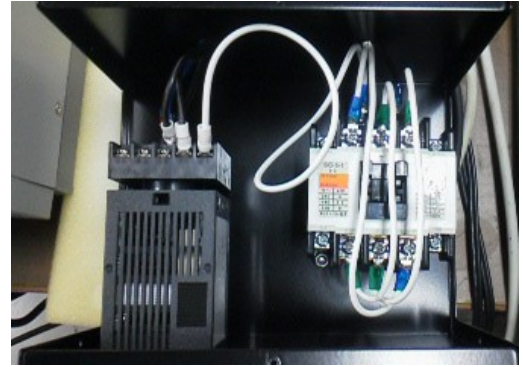
図 4.12 温度コントローラ内部 SA100 と 電源切り替えスイッチ SC-5-1
