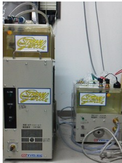
図 4.13 ペルチェシステム冷却水の循環ポンプ MP-250B (右) と MP-401CT (左)
