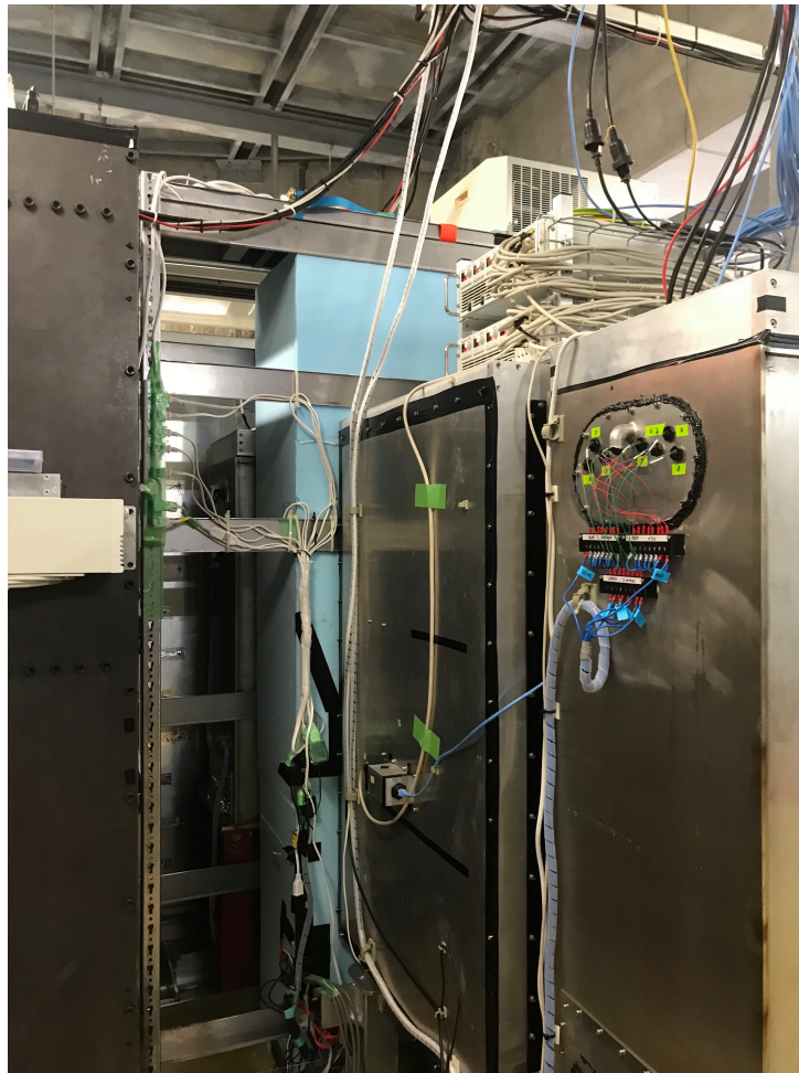
図 8.2: インストールされた NINJA 検出器. 水色の冷蔵庫の中に ECC, シフター, トラッカーが設置されており, 内部は一定の温度に保たれている.
