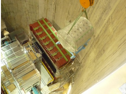
図 5.41: 外タンクのインストール風景。外タンクはクレーンによって無事ホール地下2階まで降ろされた。
