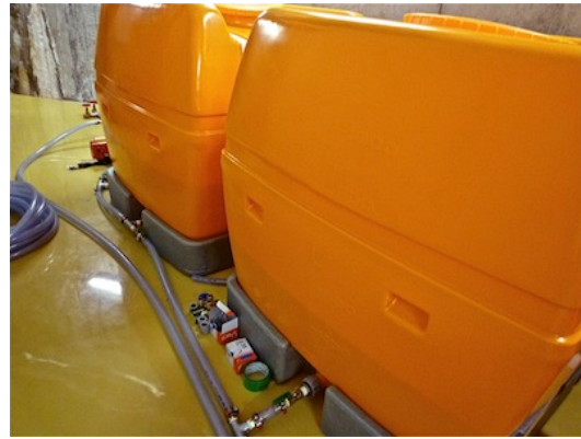
図 5.12: 合計 3000L のバッファータンク。3つのバッファータンクは互いにタンク上部と下部でホースにより接続されている。検出器に最も近い1つを水の常時循環用に使用し、残り2つは検出器から水を抜く際や水が漏れた場合の緊急時に水を逃がす用途で用いる予定である。
