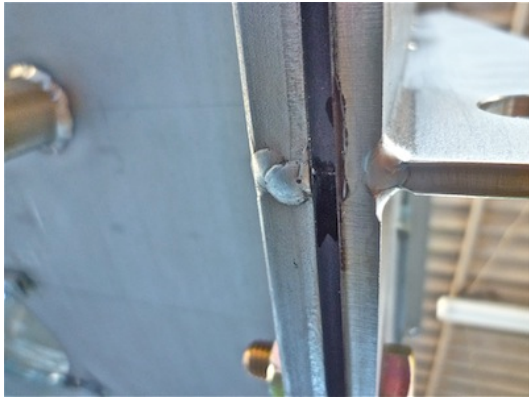
図 5.39: 板ゴムのつなぎ目からの水漏れ箇所。図では分かりにくいですが、板ゴムの隙間から少量だが水漏れをしている。板ゴムは 1/4 品を突き合わせで接着しているため、このような水漏れが生じたと見られる。繋ぎ目の位置を工夫することで調整した。
